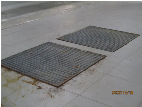
ภาพที่ 2-9 บ่อดักน้ำมันและไขมัน
